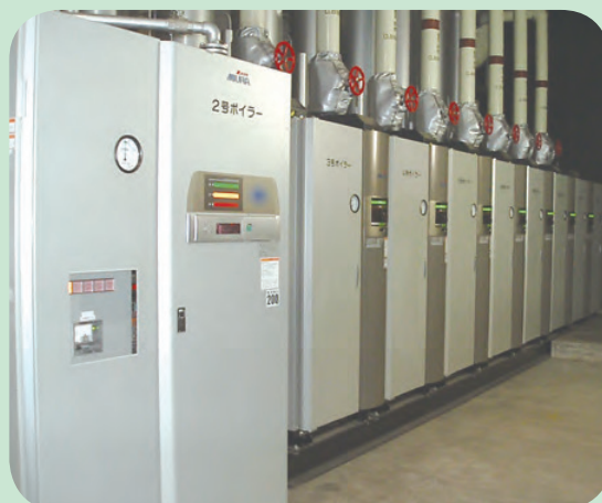
天ねんガスを使ったボイラー
