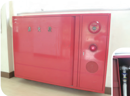
報知器と消火せん
