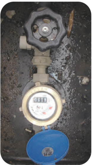
水道メーター
