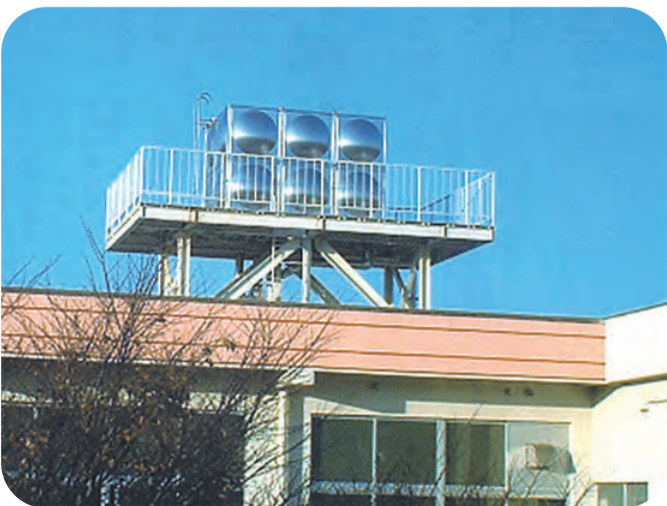
学校のちょ水タンク
