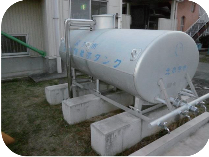
① ひじょうきゅう 非常給水タンク
